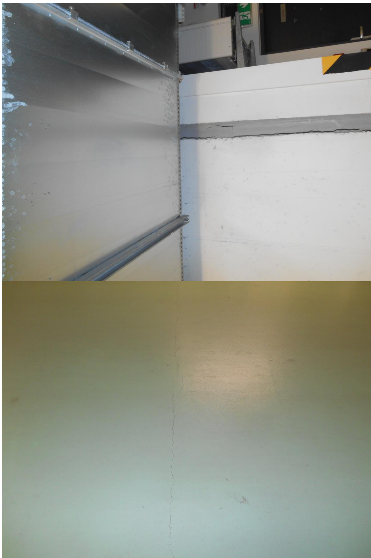
Foto 3... svislá a vodorovná dilatace v 1.PP., Foto 4...Trhlina v podlaze 1.PP.
