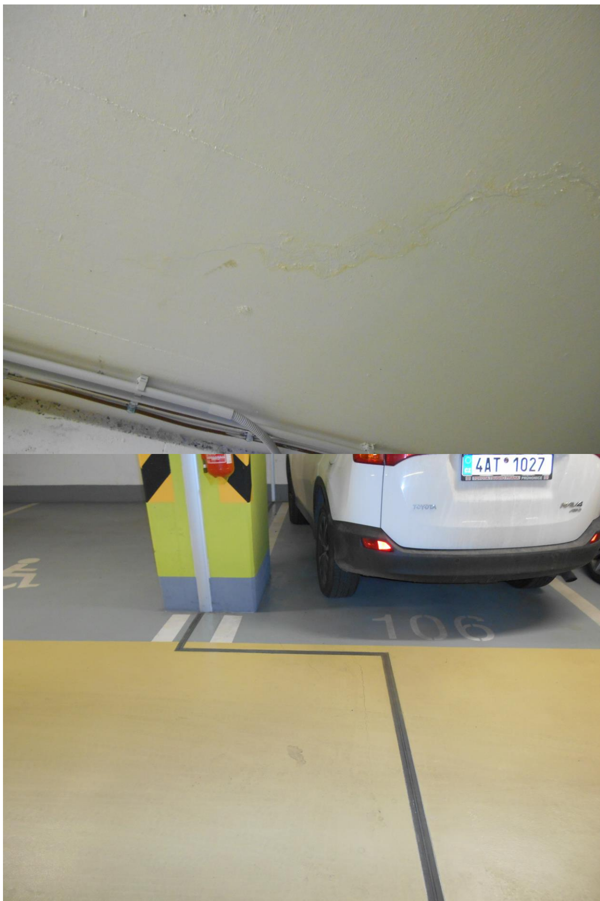
Foto 9...zátek ze stropu 2.PP, Foto 10... dilatace v 2.PP
