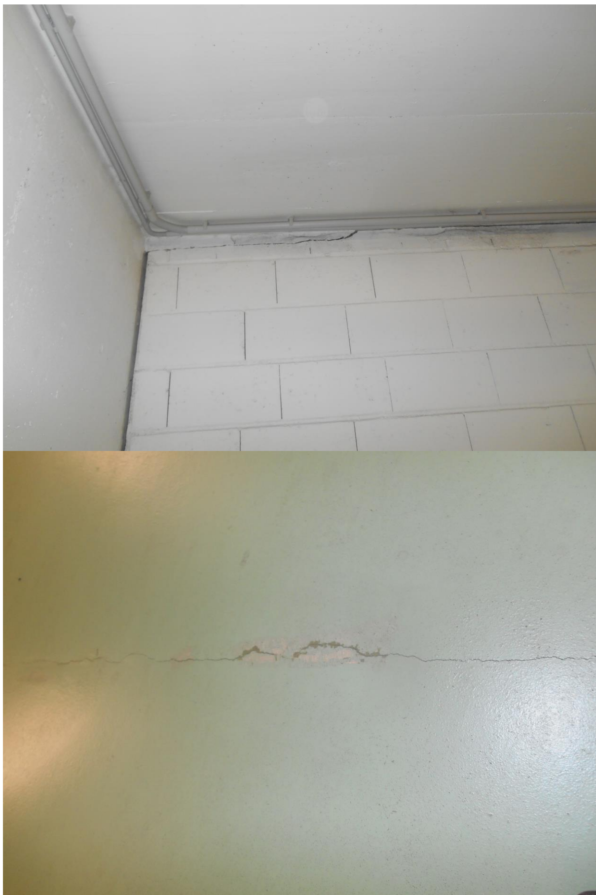
Foto 1...trhlina vyzdívky v 1.PP., Foto 2...trhlina v podlaze 1.PP.
