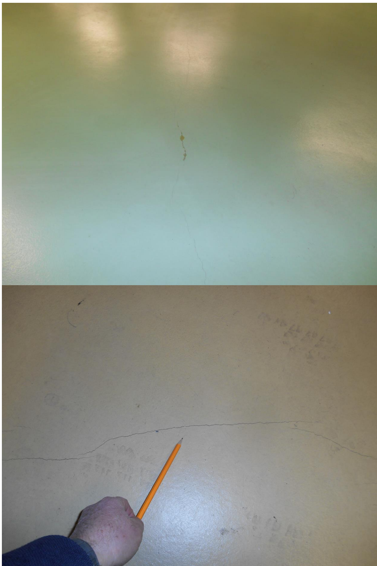
Foto 5...Trhlina v podlaze 1.PP., Foto 6... trhlina v podlaze 2.PP.
