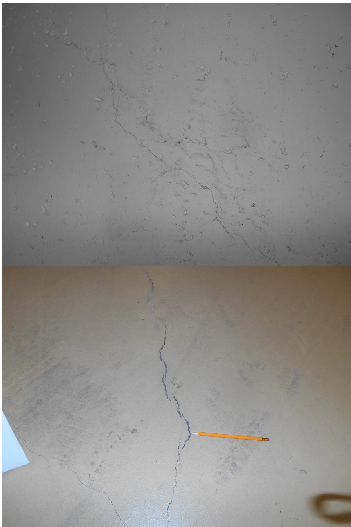
Foto 11... Trhliny stropu 2.PP, Foto 12...trhliny v podlaze 2.PP
