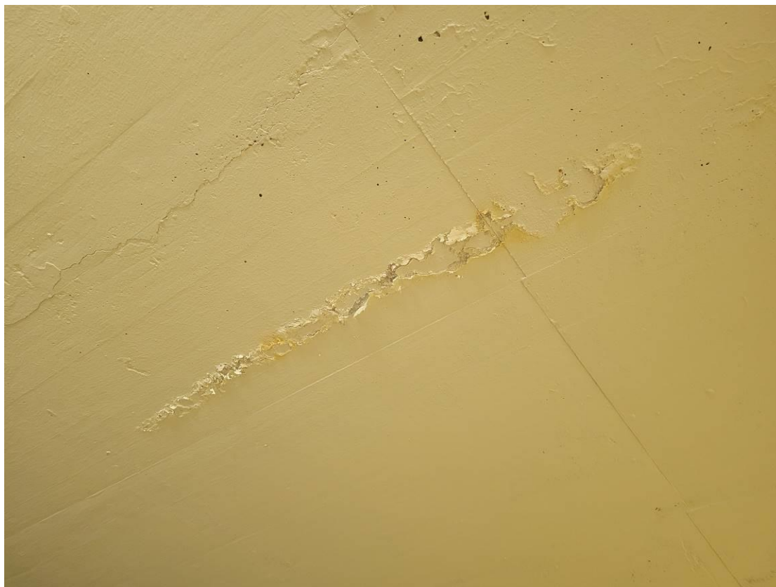
Obr. 33. Znaky prosakování vody skrz stropní desku nad 2. PP (fotografie stropu). (v Příloze 2 značeno jako fotografie č. 15)
