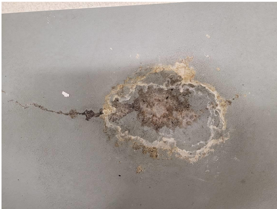
Obr. 25. Vzlinání vody skrz základovou desku (v Příloze 2 značeno jako fotografie č. 7)
