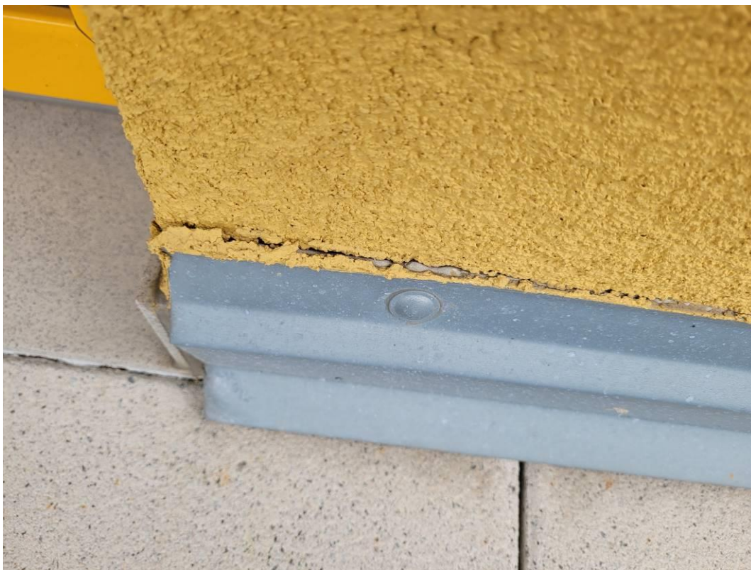
Obr. 15. Trhliny v napojení fasádové lišty na vnější omítku (snímek pořízen z východní terasy bytové jednotky č. 272).
