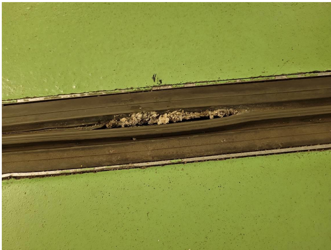
Obr. 35. Poškození dilatačního profilu. (v Příloze 2 značeno jako fotografie č. 17)
