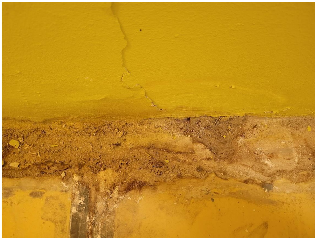
Obr. 30. Vzlínání vody skrz základovou desku (v Příloze 2 značeno jako fotografie č. 12)
