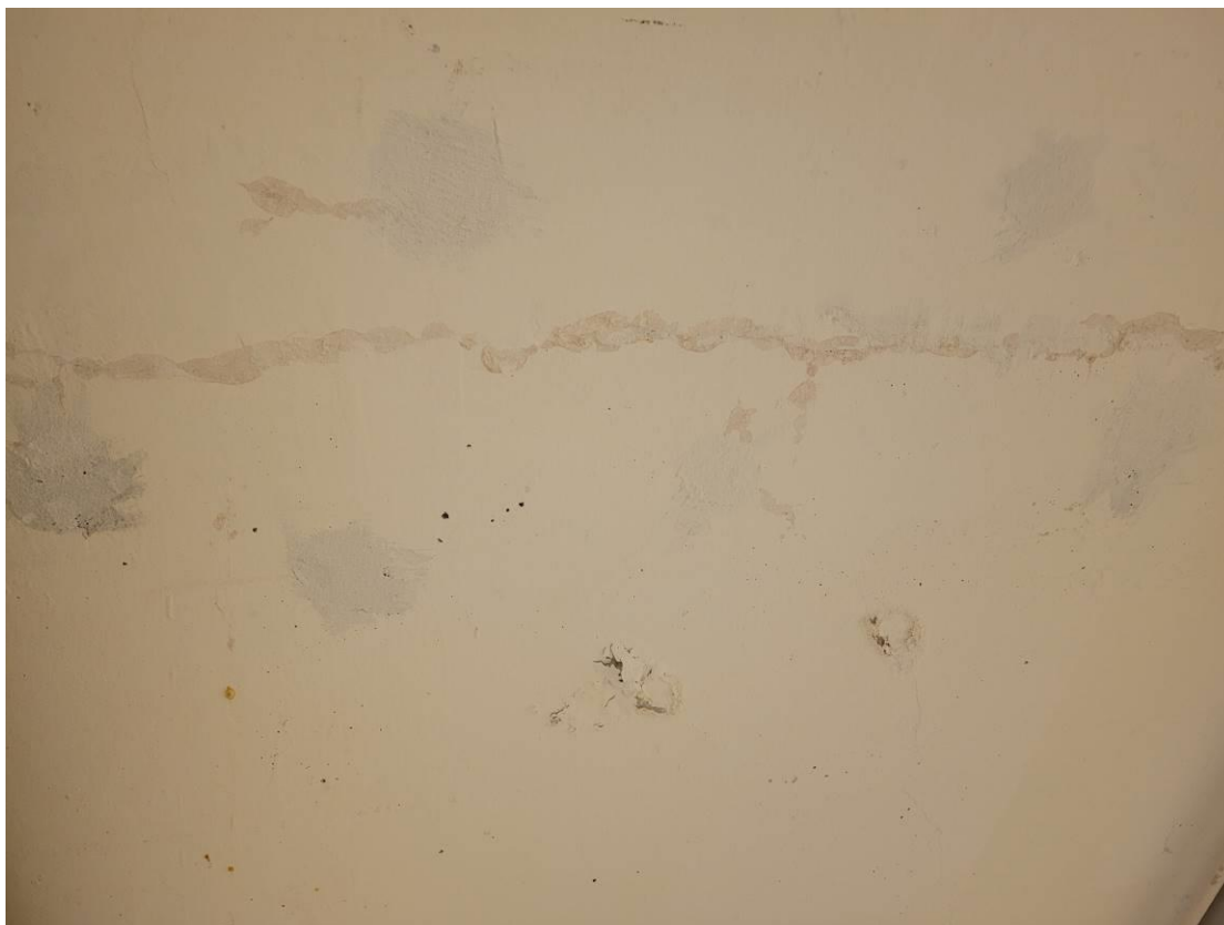
Obr. 32. Znaky prosakování vody skrz stropní desku nad 2. PP (fotografie stropu). (v Příloze 2 značeno jako fotografie č. 14)
