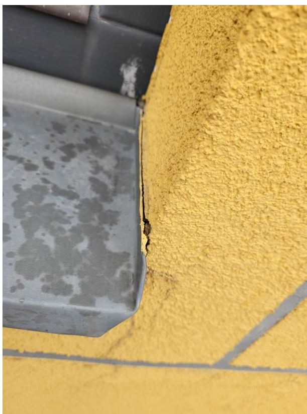
Obr. 8. Neutěsněná mezera mezi oplechováním parapetu a ostěním – návaznost oplechování na obvodový plášť je nevhodně řešeno (snímek pořízen ze západní terasy bytové jednotky č. 175).
