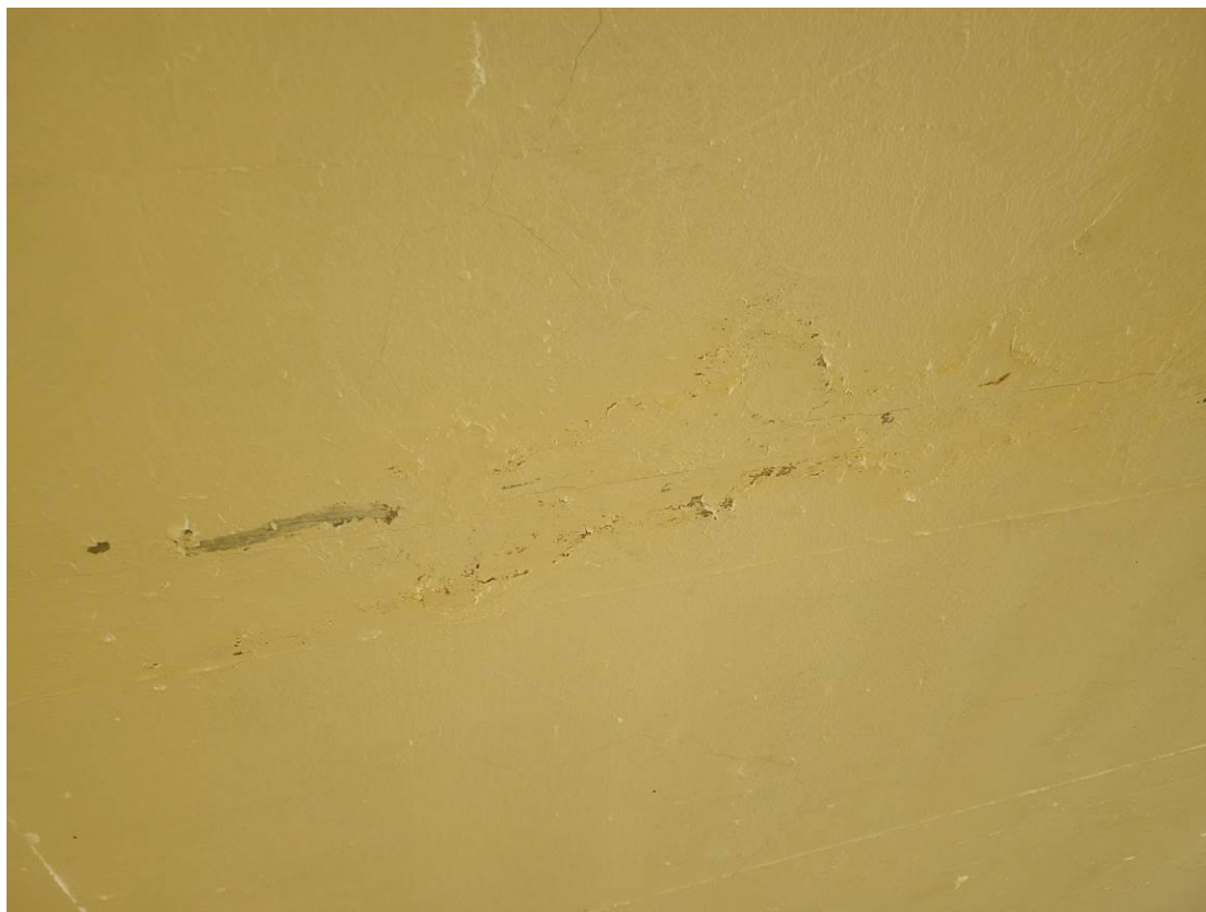
Obr. 23. Prosakování vody skrz trhlinu ve stropní desce nad 2. PP (v Příloze 2 značeno jako fotografie č. 5)
