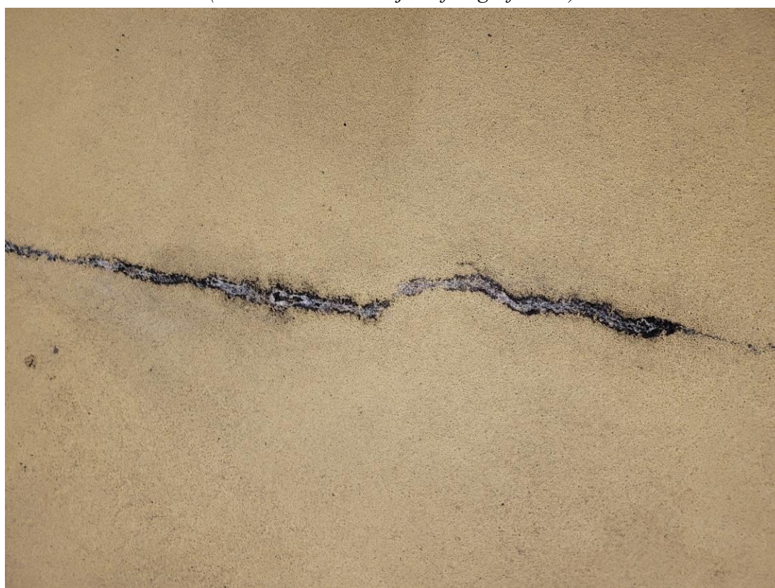
Obr. 20. Vzlinání vody skrz trhlinu v základové desce (v Příloze 2 značeno jako fotografie č. 2)
