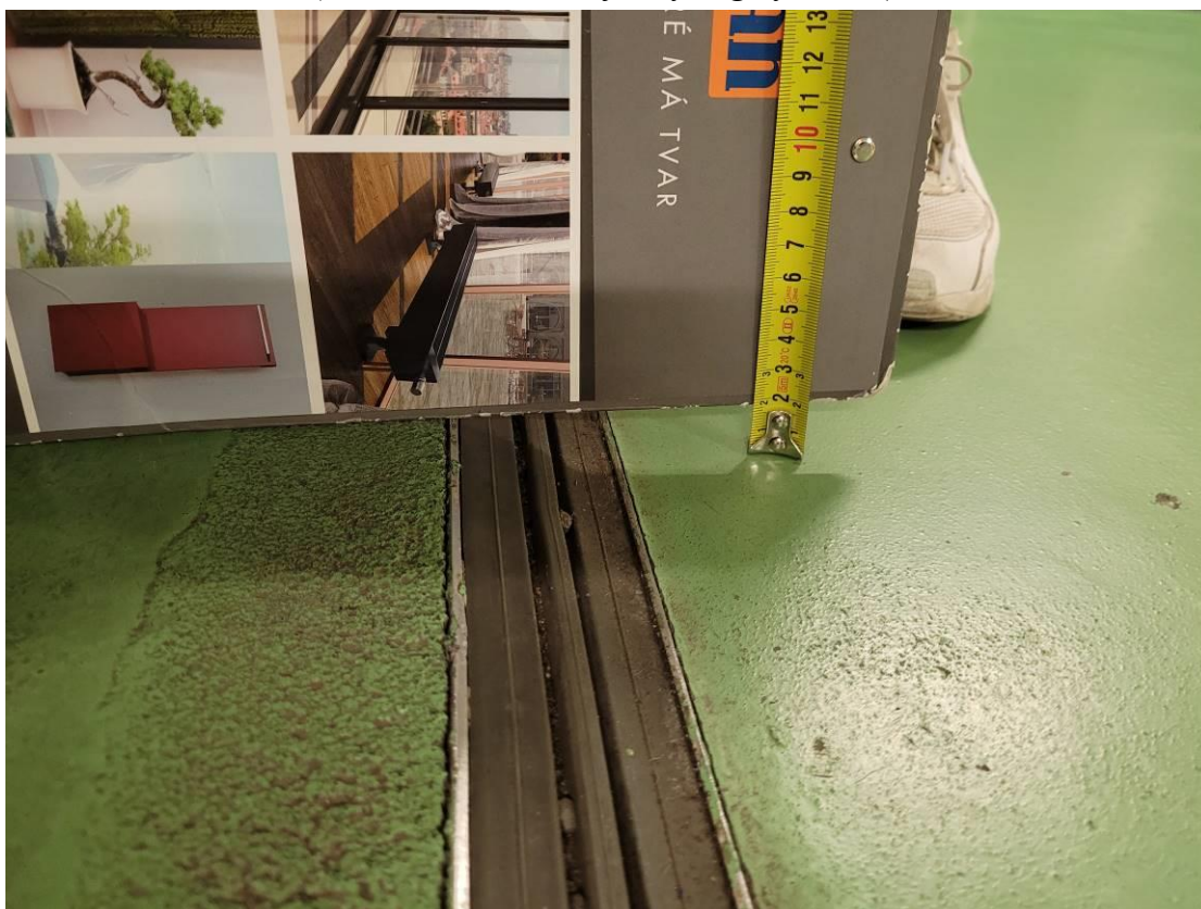
Obr. 34. Došlo k relativně významnému výškovému posunu v místě objektové dilatace. (v Příloze 2 značeno jako fotografie č. 16)
