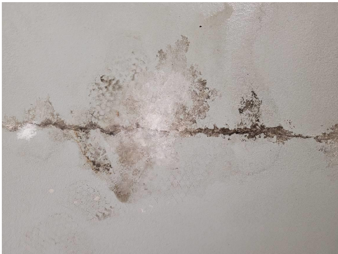
Obr. 26. Vzlinání vody skrz trhlinu v základové desce (v Příloze 2 značeno jako fotografie č. 8)
