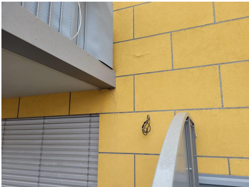
Obr. 9. Pohled na část fasády, která se nachází severně od terasy bytové jednotky č. 175. I zde je patrný puchýř na omítce a poškození omítky v blízkosti styku balkónu s obvodovým pláštěm (snímek pořízen ze západní terasy bytové jednotky č. 175).
