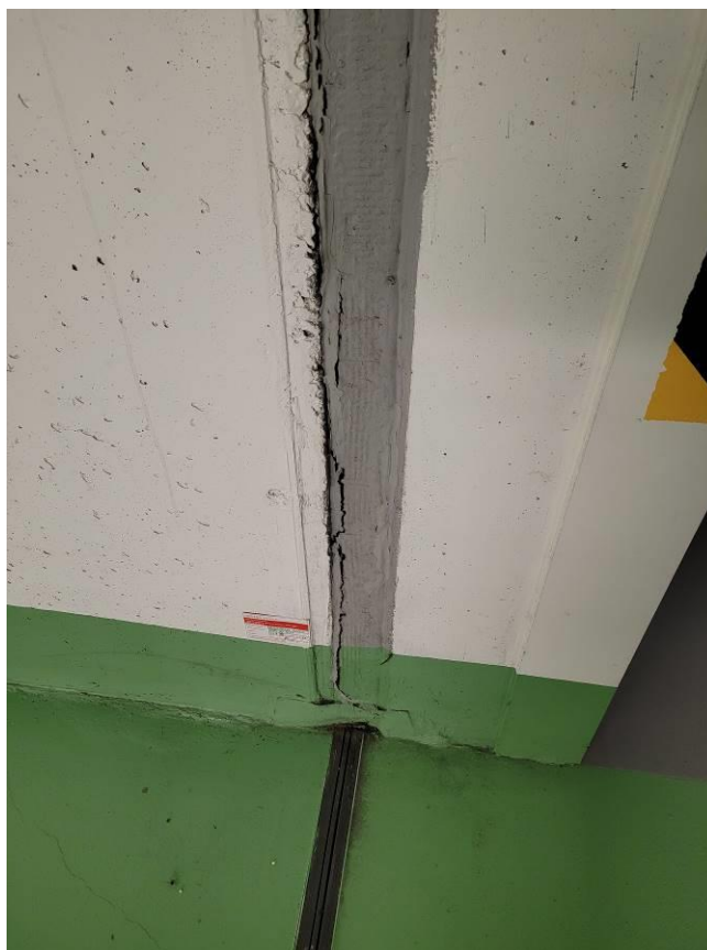
Obr. 37. Trhliny ve výplni dilatační spáry – pouze estetický charakter vady (v Příloze 2 značeno jako fotografie č. 19)
