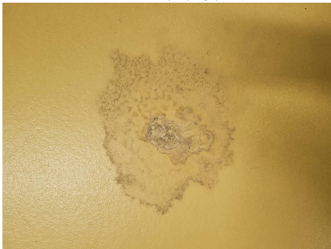
Obr. 22. Vztlínání vody skrz základovou desku (v Příloze 2 značeno jako fotografie č. 4)
