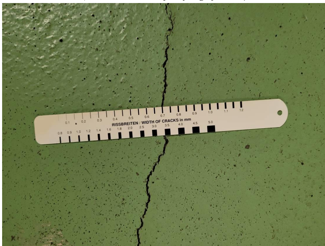
Obr. 38. Měření šířky trhliny na podlaze 1. PP. (v Příloze 2 značeno jako fotografie č. 20)
