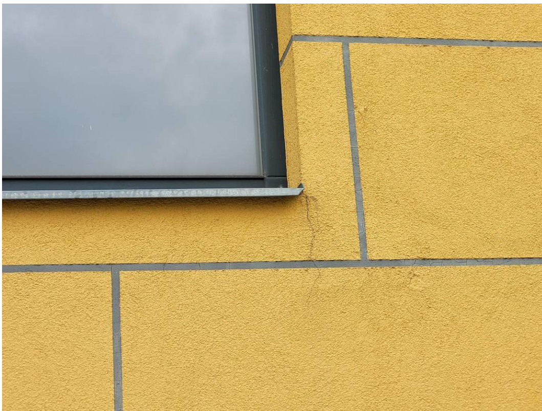
Obr. 7. Svislá trhlinka v omítce v rohu okna (snímek pořízen ze západní terasy bytové jednotky č. 175).
