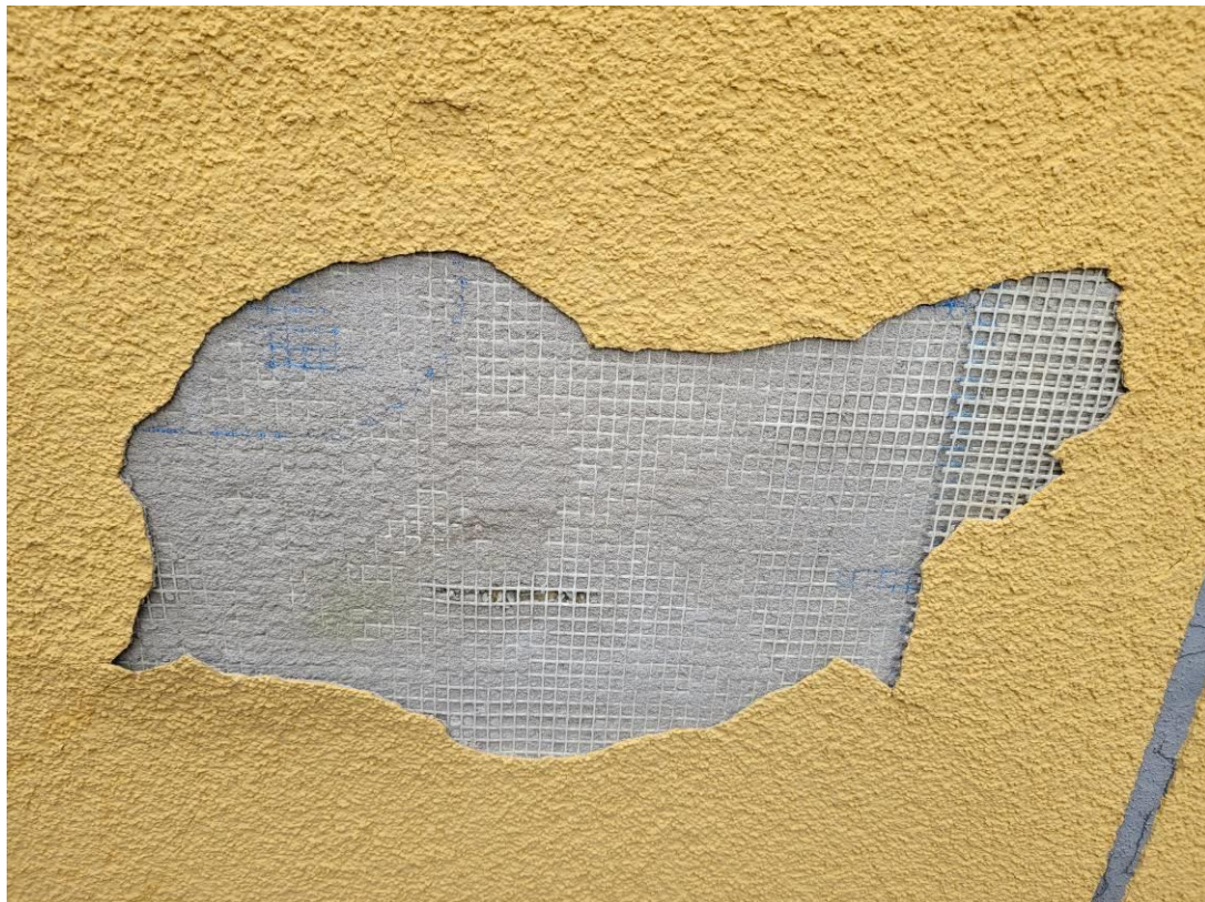
Obr. 4. Po odstranění nesoudržné omítky byla obnažena armovací sklovláknitá tkanina (snímek pořízen ze západní terasy bytové jednotky č. 175).
