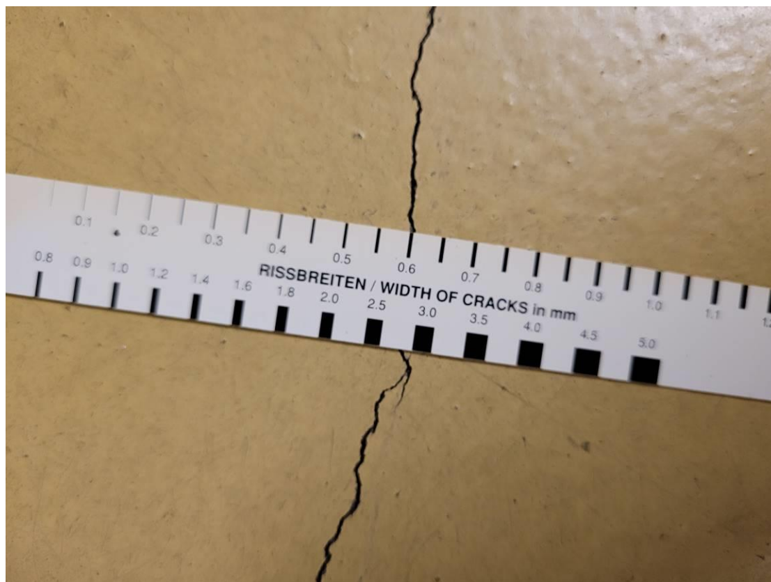
Obr. 21. Měření šířky trhliny v základové desce (v Příloze 2 značeno jako fotografie č. 3)
