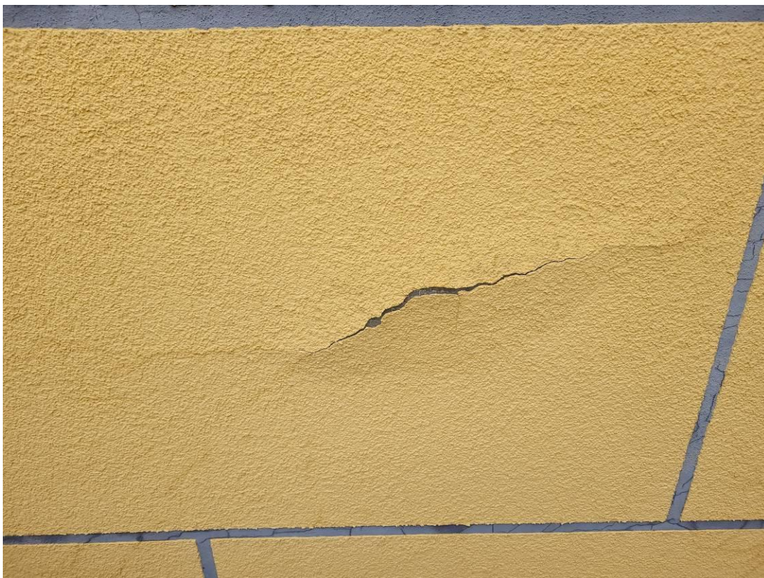
Obr. 3. Bližší pohled na lokální vzduť (puchýř) na vnější omítce (snímek pořízen ze západní terasy bytové jednotky č. 175).
