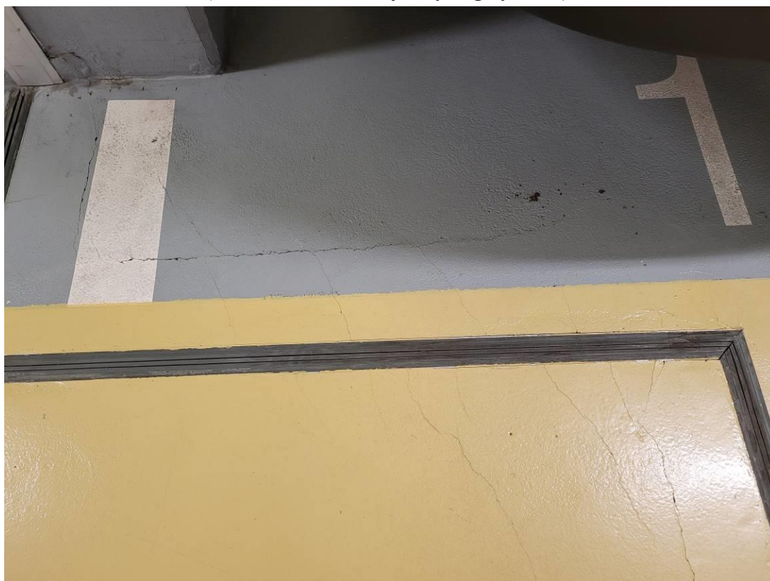
Obr. 24. Trhliny v okolí objektové dilatace v základové desce (v Příloze 2 značeno jako fotografie č. 6)
