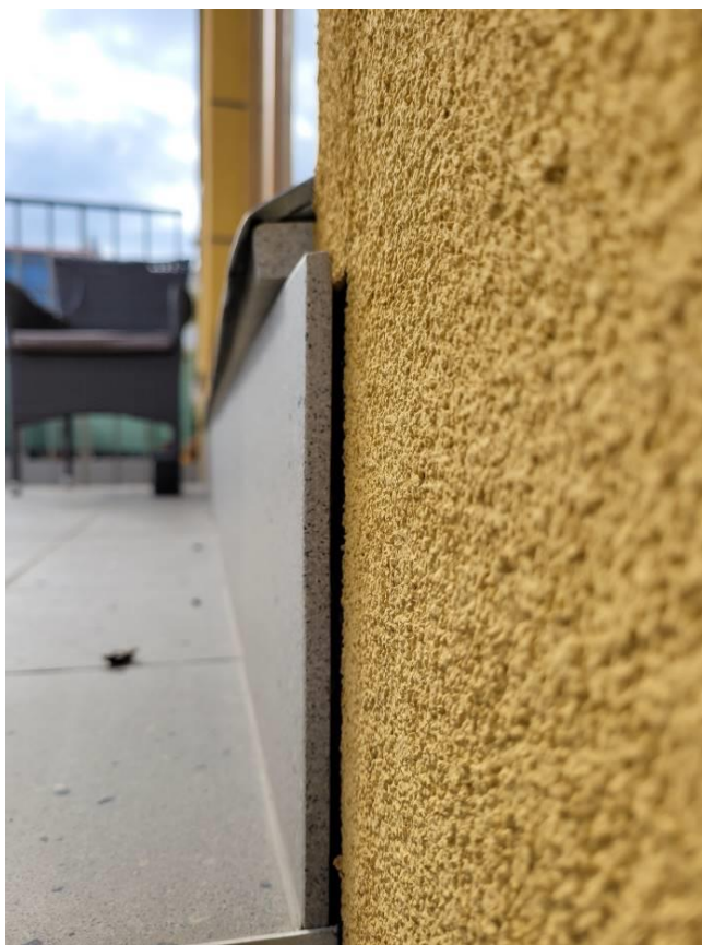
Obr. 13. Neutěsněné napojení obkladu balkónu na obvodový plášť (snímek pořízen z východní terasy bytové jednotky č. 174).
