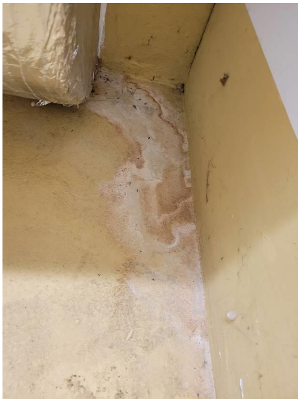
Obr. 29. Vzlínání vody skrz základovou desku (v Příloze 2 značeno jako fotografie č. 11)
