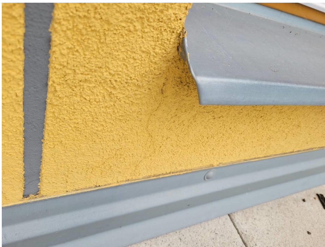
Obr. 16. Svislá trhлина na omítce v blízkosti okna (snímek pořízen z východní terasy bytové jednotky č. 272).
