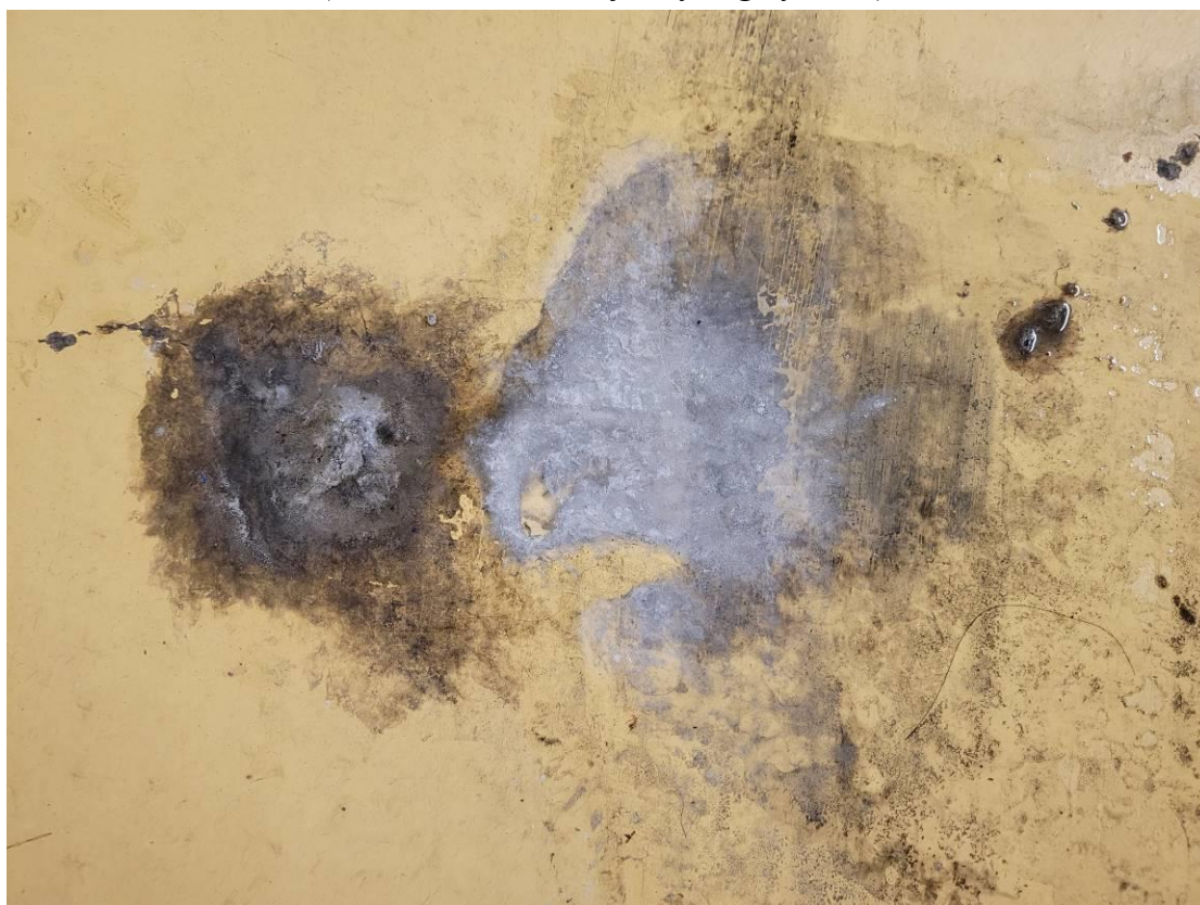
Obr. 28. Vzlínání vody skrz základovou desku (v Příloze 2 značeno jako fotografie č. 10)
