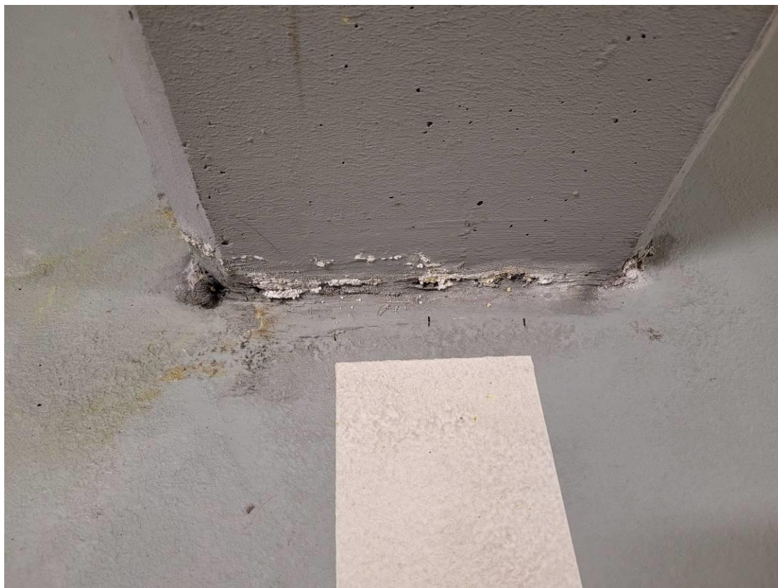
Obr. 27. Vzlínání vody skrz při obvodu sloupu na základové desce (v Příloze 2 značeno jako fotografie č. 9)
